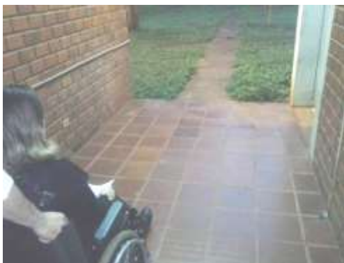
Figura 20 – Passarela com dimensões inadequadas
