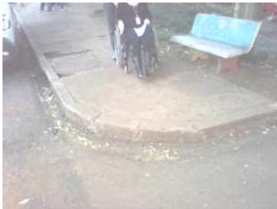
Figura 124 – Falta de rampas de acesso
