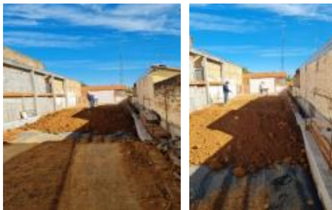
Figura 12: nivelamento do terreno Figura 13: Compactação do terreno Fonte: Elaborado pelos autores Fonte: Elaborado pelos autores
